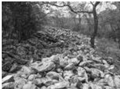
Figura 004 – Primeira avaliação – troço do pano de muralha do Jau. É possível ver que existem alguns problemas de conservação da estrutura. Não é de estranhar o saque de pedras para reutilização. Igualmente a vegetação em torno e no centro do monumento tornou-se bastante densa. Foto: André Serdoura.
