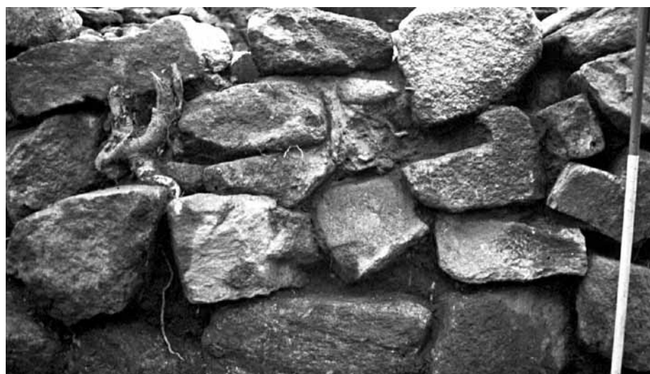
Fig. 2.3 – Pormenor do aparelho da muralha do castro de Penices, notando-se a ausência de aparelhamento e irregularidade das pedras, bem como o travamento deficiente do aparelho.
