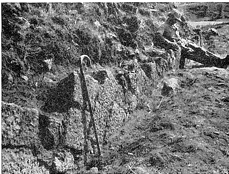
Fig. 4 — 2. a muralha destruída quase até ao alicerce.
