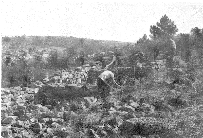
Fig. 5 — Aspecto dos trabalhos na parede linear do lado Sul, comum a toda a fiada de casas.
