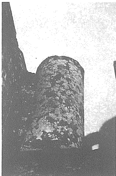
Fig. 12 — Fotografia da Sé velha, Coimbra, ilustrando a presença de deteriogenes, neste caso líquenes.
